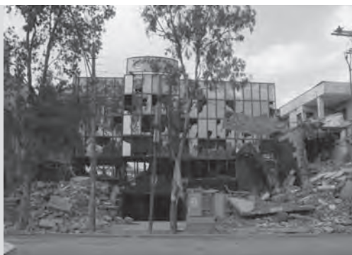
شکسته شدن و فرو ریختن شیشه‌های نمای ساختمان در زلزله ۱۳۸۲ بم
