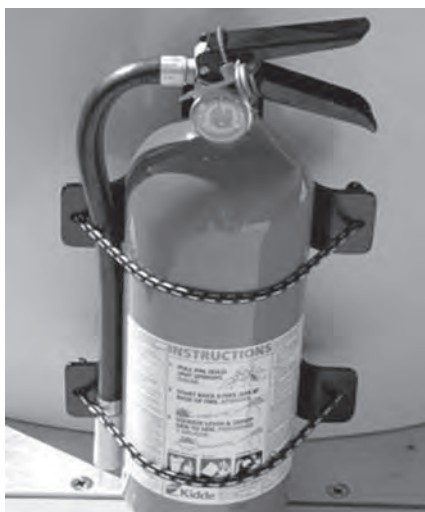
کپسول اطفای حریق مهار شده
