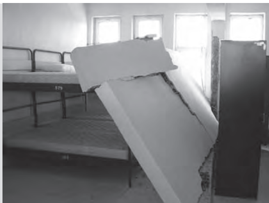
تخریب تیغه جداساز در اثر زلزله
